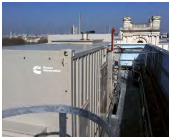
Cummins ESB установили резервный электрогенератор работающий на природном газе на территории Института 'Инженеров-строителей' в Лондоне.
